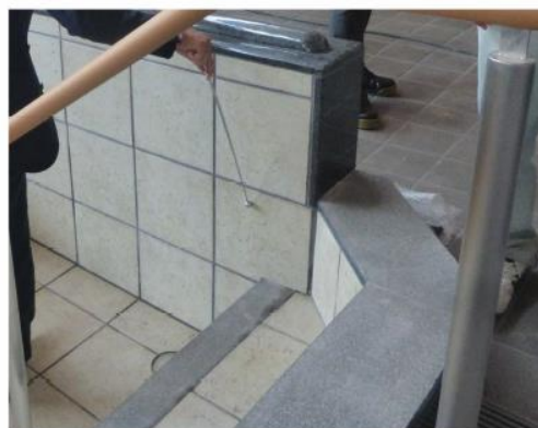
打診棒でタイルをたたき、鬆の有無を確認する 鬆が確認されたら、施工し直す
