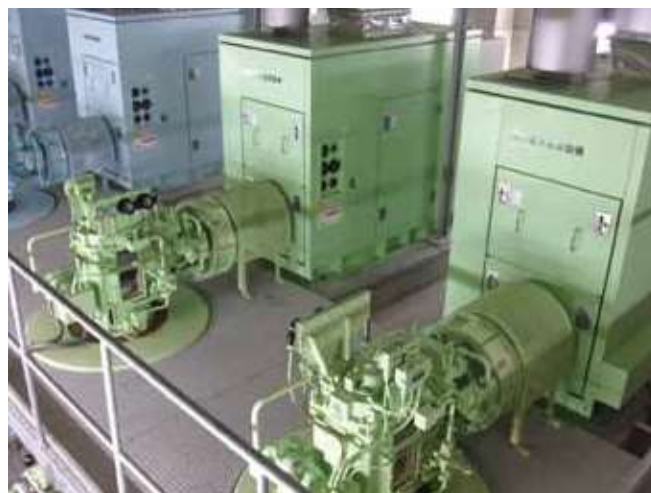
大相模調節池排水機場
